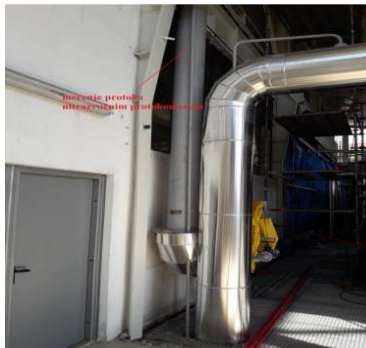
Slika A 2.6 Merno mesto za merenje protoka radnog fluida na izlazu iz bilansne granice (nema potrebe za bilo kakvim radovima osim skidanja dela izolacije i postavljanja skele za rad)
